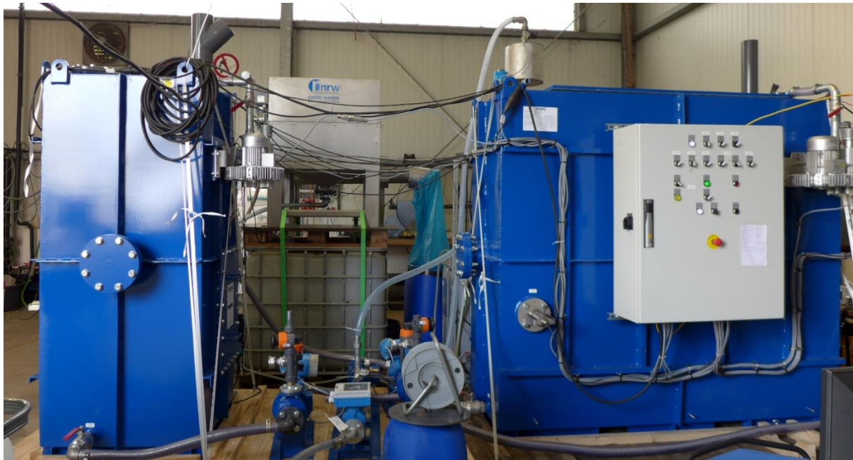
Bild 42 Foto der Versuchsschiffskläranlage im Technikum des ISAH (links: Denitank, rechts: MBR-Tank, im Hintergrund: Siebrechen)
